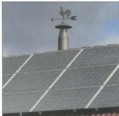
Aufdach-Photovoltaikanlage entbinden nicht von Windsogsicherung
