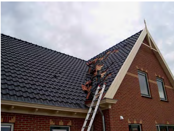
Beispiel Sturmschaden am Steildach
